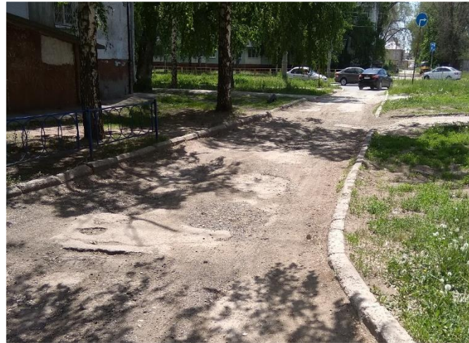
Фото объекта «До»
