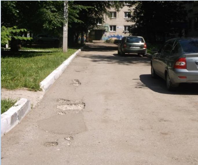
Фото объекта «До»
