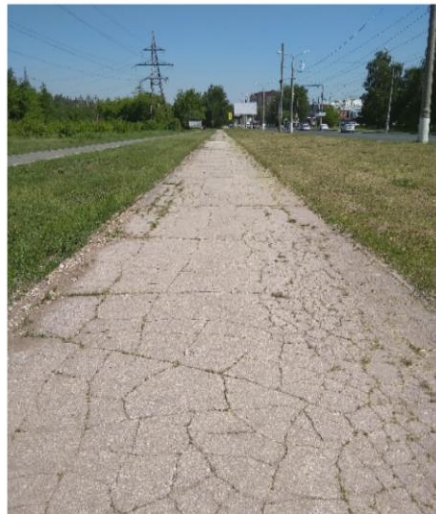
Фото объекта «До»
