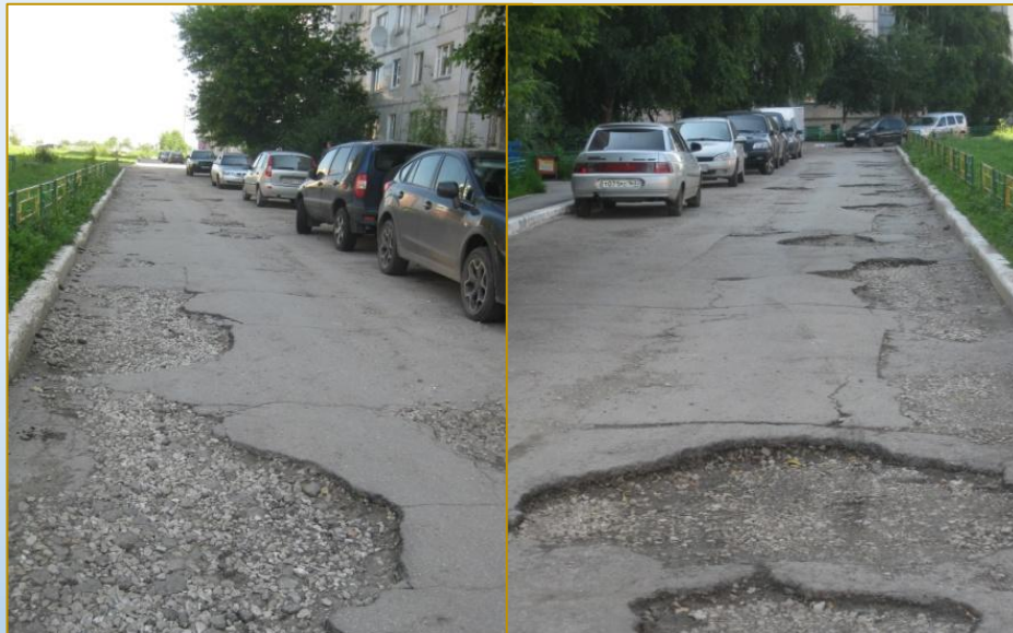
Фото объекта «До»
