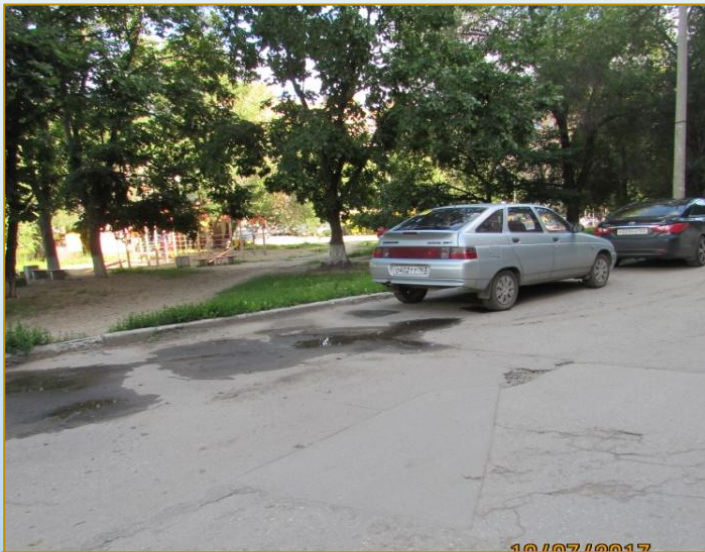
Фото объекта «До»
